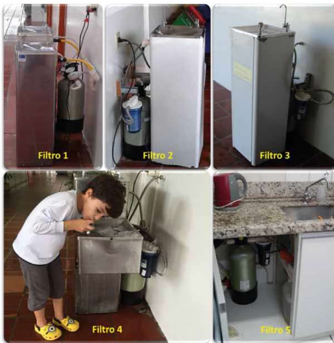
Figura 4 – Imagens dos filtros F1, F2, F3, F4 e F5 instalados em pontos de consumo no Campus da UNISC, em Santa Cruz do Sul, RS.
